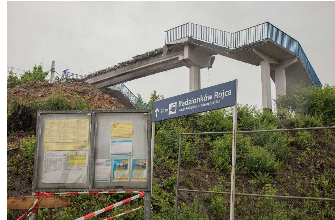
Wyburzana kładka nad torami kolejowymi.
